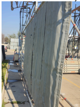
Cierre parcial para estructuras o andamios
